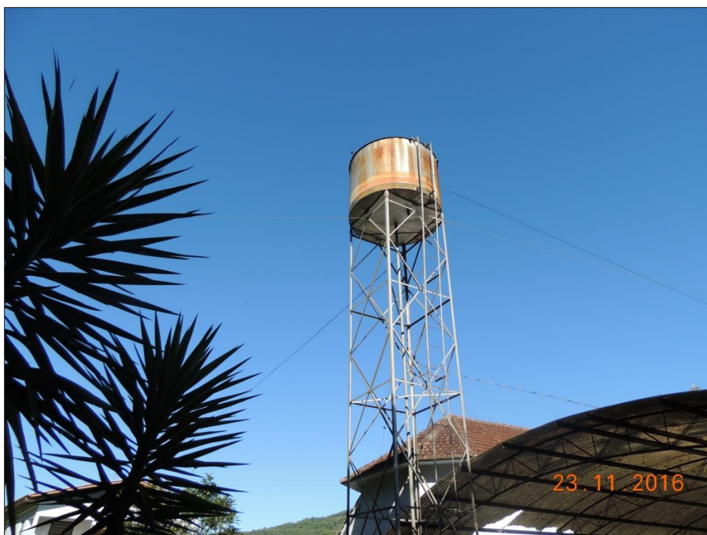
Figura 10: Reservatório 10m³ Metálico - PM de Riozinho Fonte: Keyassociados, 2016.
