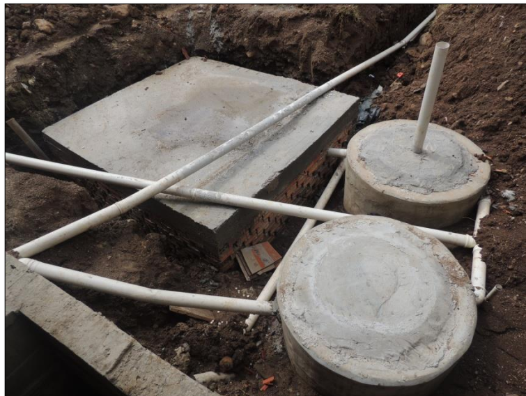
Figura 45: Detalhe do Sistema de Esgotamento Sanitário em Riozinho Fonte: Keyassociados, 2016.
