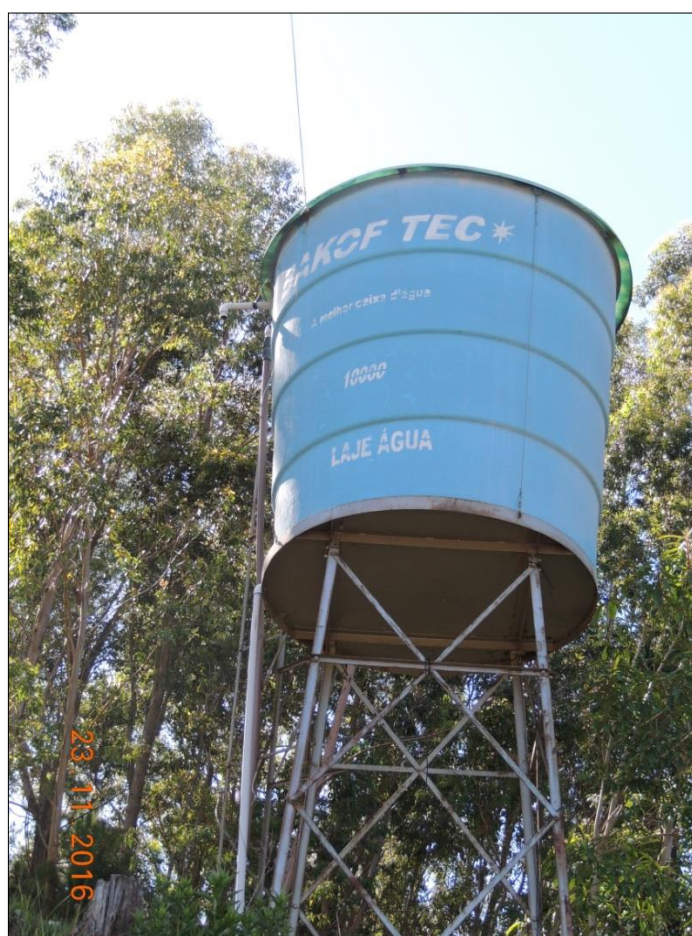
Figura 12: Reservatório 10m 3 em Fibra - PM de Riozinho. Fonte: Keyassociados, 2016.
